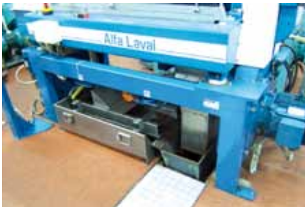
Figura 14 - Canaletta a pavimento per passaggio e ispezione rete trasporto sansa
