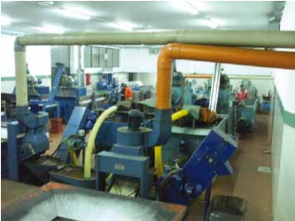
Fig. 11 -Tubazioni aeree per l'allontanamento delle foglie
